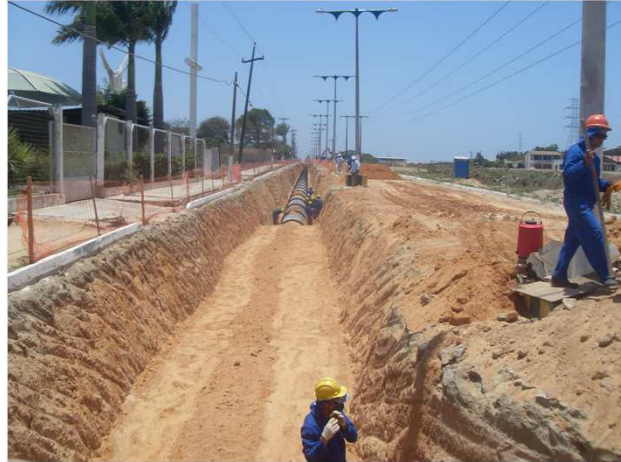
Trecho V – Tubulação
